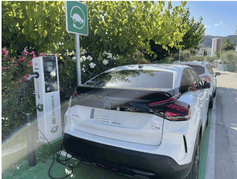
PUNTO DE RECARGA VEHÍCULOS ELÉCTRICOS
